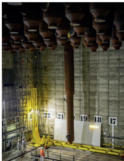
Photo de la dépose d'une bouteille du local échangeur Sud de Chinon A3.
